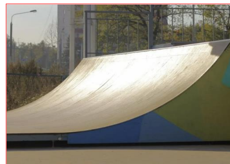
Недопустимы: щели между вертикальными, наклонными поверхностями фигур и покрытием
