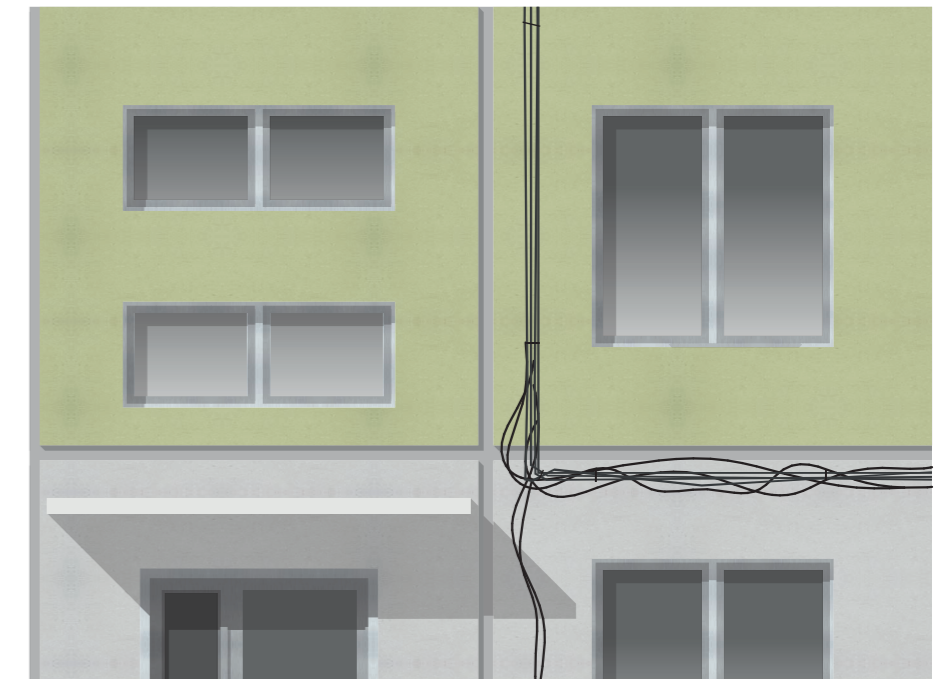
ПЛОХО. Инженерные провода расположены неупорядоченно
