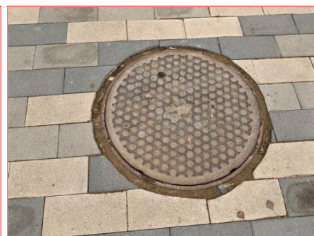
Недопустимы: круглые люки с линейной укладкой плитки
