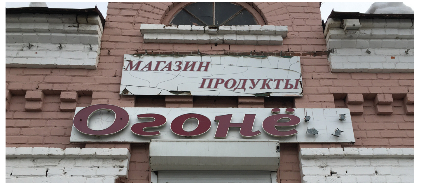
ПЛОХО. Вывески в неисправном состоянии.
