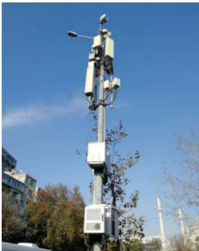
ПЛОХО. Излишнее количество нависного оборудования на дорожном столбе, создается визуальный шум
