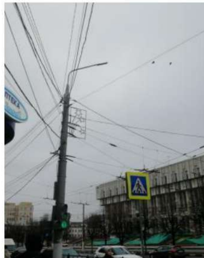
ПЛОХО. Недопустимая воздушная прокладка проводов
