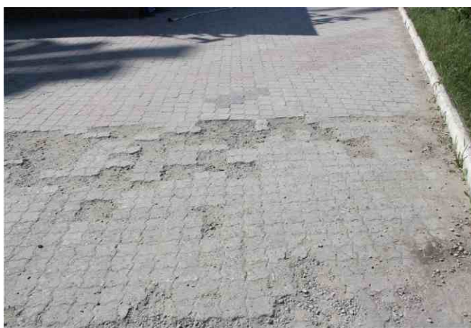
ПЛОХО. Использование некачественных материалов, бетонная
