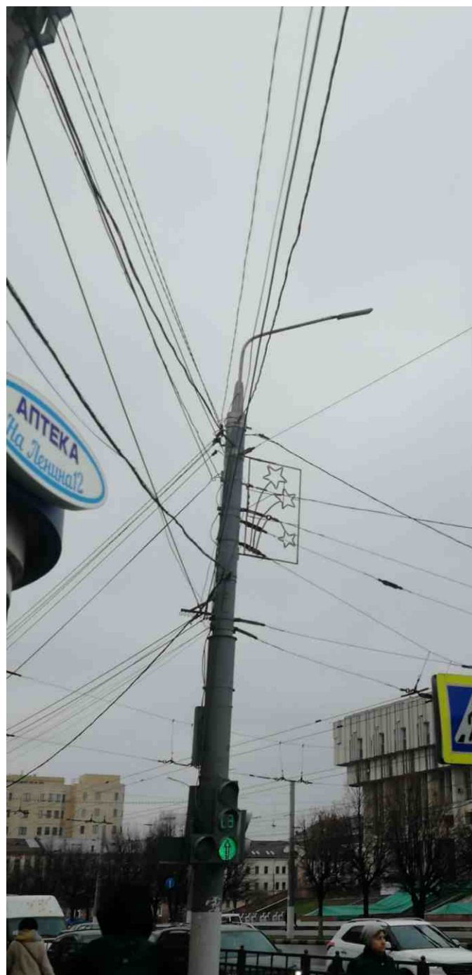
ПЛОХО. Недопустимая воздушная прокладка проводов
