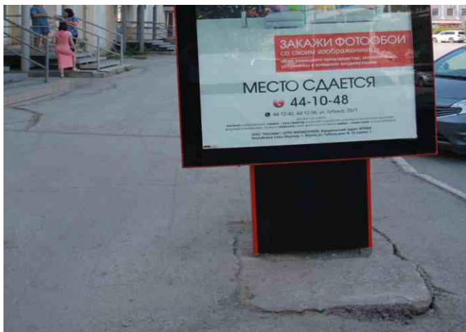
ПЛОХО. Некачественная врезка металлических столбов в мощение
