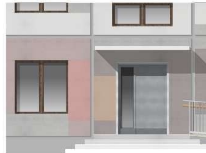
ПЛОХО. Цветовое решение фасада неоднородно, покраска стен выполнена хаотично с использованием разных оттенков одного цвета
